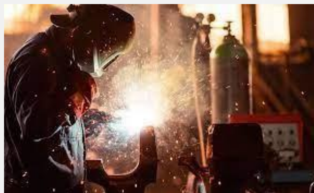
Trabajo en caliente (incendio / explosión)
